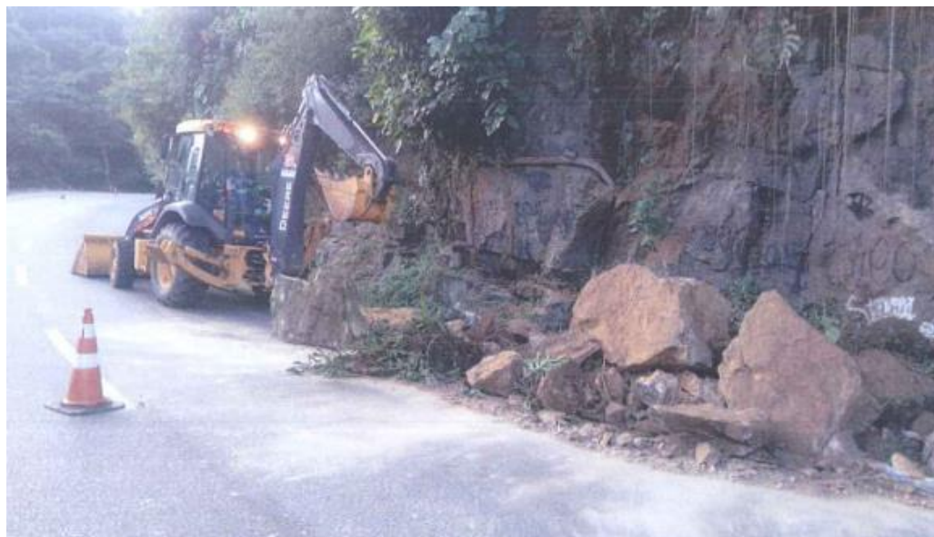
Foto 2 – Queda de Barreira - Km 051+200 N
