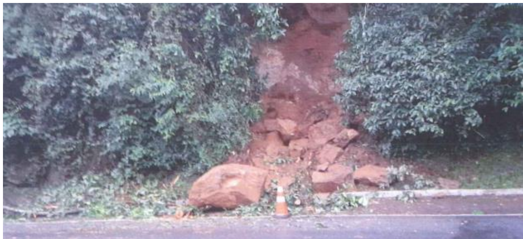
Foto 1 – Queda de Barreira – Km 044+200 S
