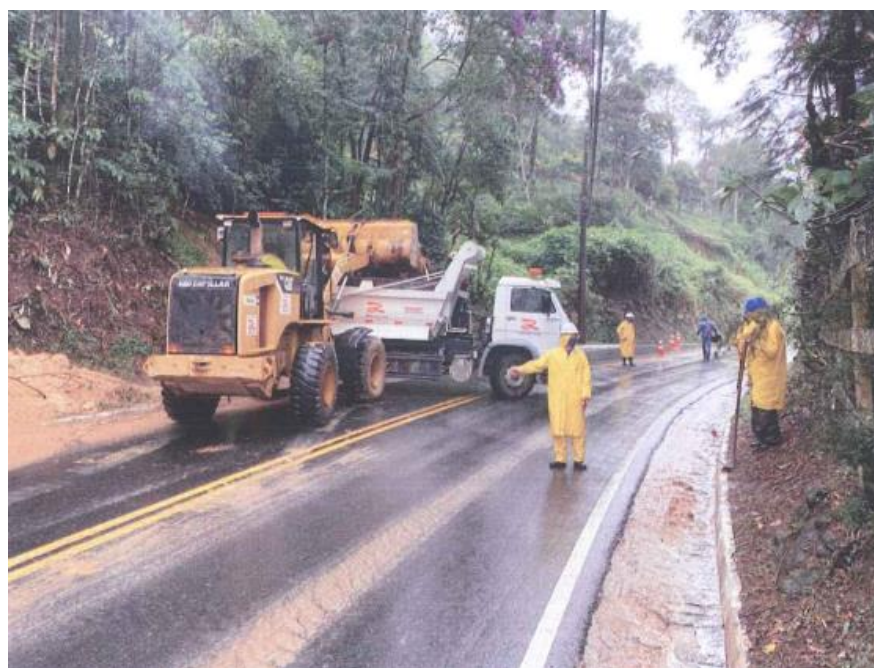
Foto 4 – Queda de Barreira - Km 067+200 N
